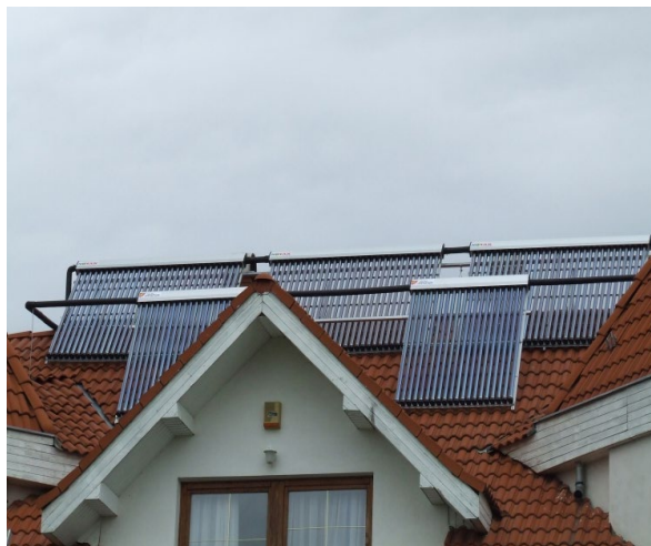
268. ábra Tetőn elhelyezett vákuumcsöves kollektorok
