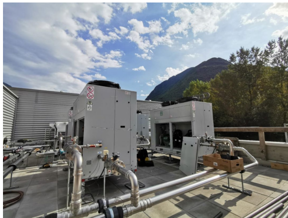
18. ábra EUROKLIMAT HERA R290 típusú inverteres hőszivattyúk tetőre helyezve.
