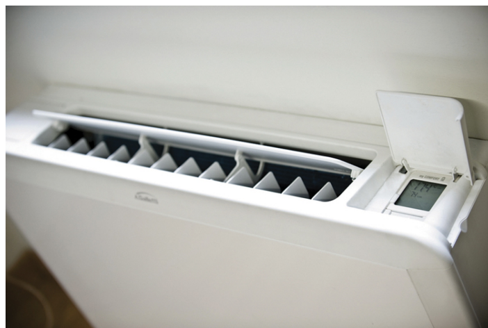
174. ábra Fan-Coil lakásberendezés
