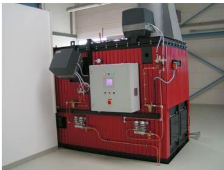
40. ábra Hulladékégető kazán
