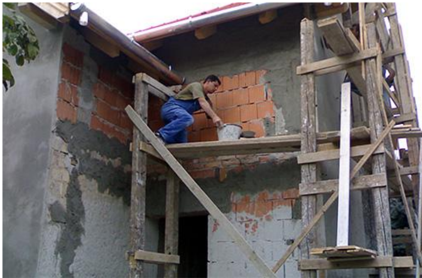
14. ábra Szabálytalan munkaállványon munkát végezni tilos
