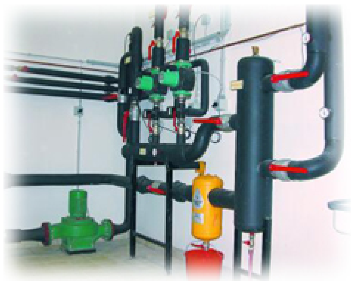
1. ábra Gondosan tervezett és kivitelezett az épületgépészeti hőközpont
